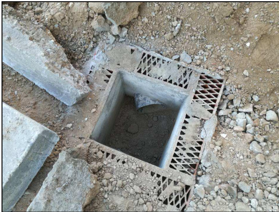
Fotografia núm. 19: arqueta de registre de la conducció d'aigües pluvials
