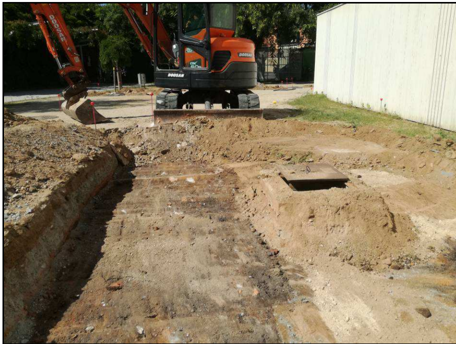
Fotografia núm. 21: arqueta de registre de la conducció d'aigües pluvials
