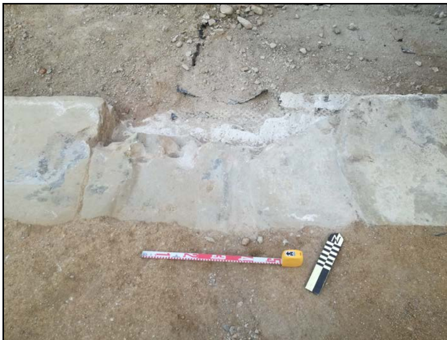
Fotografia núm. 29: pedra de llinda afectada per l'obertura de la rasa perimetral per al drenatge de l'edifici
