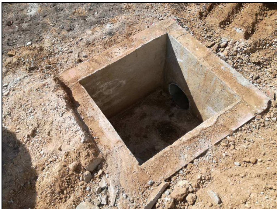
Fotografia núm. 20: arqueta de registre de la conducció d'aigües pluvials
