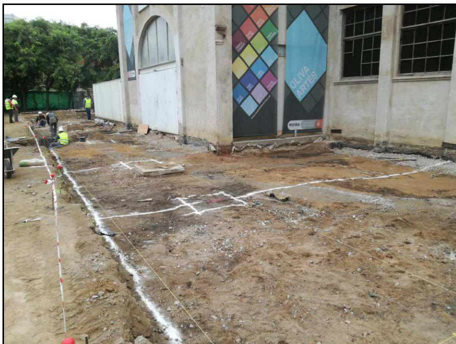
Fotografia núm. 48: plantejament de l'entramat de riostes i pous per a pilars
