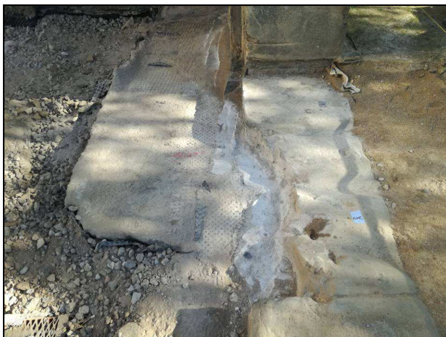
Fotografia núm. 30: pedra de llinda afectada per l'obertura de la rasa perimetral per al drenatge de l'edifici
